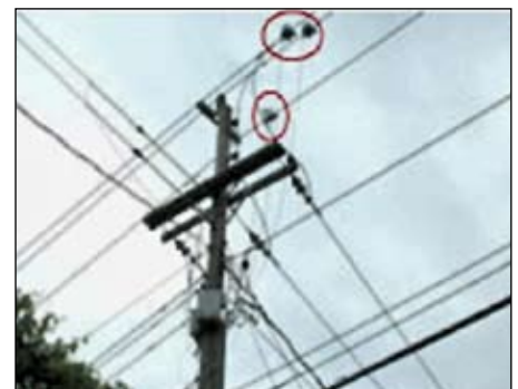
Рис. 6. Размещение датчиков фирмы Airak, Inc. на воздушной линии электропередачи
