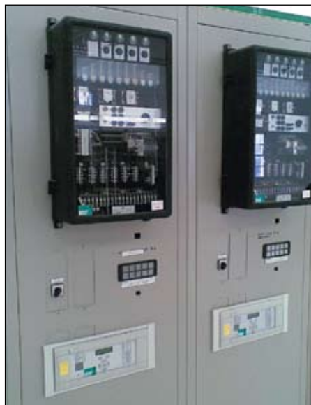
Рис. 17. Фрагмент панели дистанционной защиты ответственных линий 160 кВ, содержащей электромеханические реле типа LZ31 (вверху), включенные на параллельную работу с микропроцессорными защитами типа MiCOM P437 (внизу)
