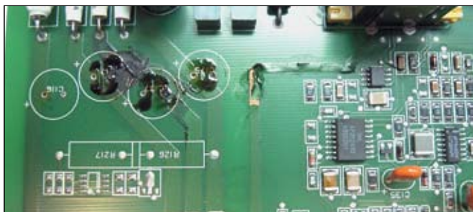
Рис. 10. Медные дорожки печатной платы ИИП, поврежденные электролитом, просочившимся из конденсаторов
