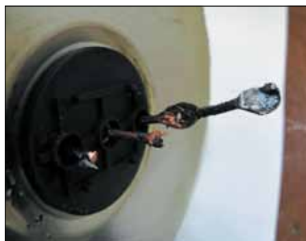
Рис. 5. Результат отказа плохо сконструированного предохранителя
